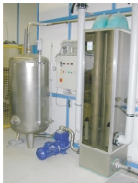
Figuur 11: Verticaal opgestelde warmtewisselaar met doorvoerpomp, buffervat en controle-unit. Dit is een getordeerde pijpwarmtewisselaar. De gedraaide pijpen moeten vervuiling voorkomen (bron:JohnsonDiversey).
