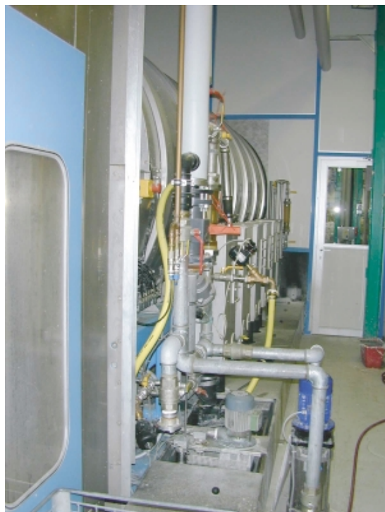
Figuur 16: Perswaterrecuperatie op een wasstraat (bron: JohnsonDiversey).
